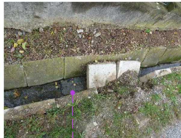
- existujúce odvodnenie cesty sa rozpadáva
