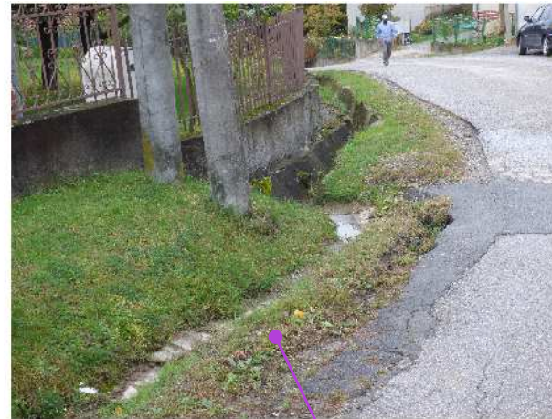
- existujúce dažď. žľaby podliehajú deštrukcii, výmena je nutná z funkčného ako aj estetického dôvodu
